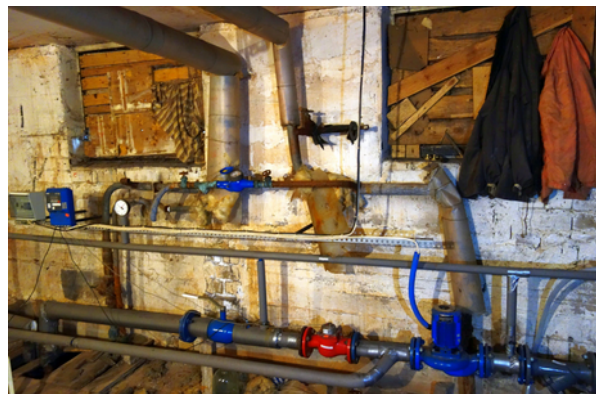
Joonis 2.1.12. Tilsi keskus 5 soojussõlm
