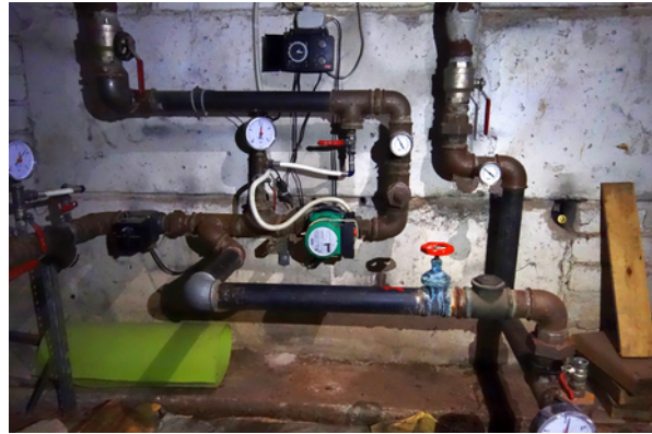
Joonis 2.1.8. Tilsi keskus 3 soojussõlm
