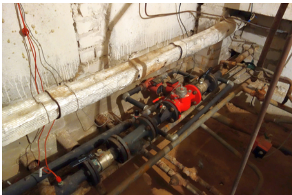
Joonis 2.1.11. Tilsi keskus 4 soojussõlm
