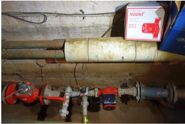
Joonis 2.1.7. Tilsi keskus 2 soojussõlm
