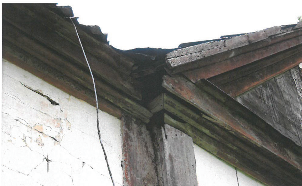
Foto 6: Vaade kahjustunud neelule räästas
