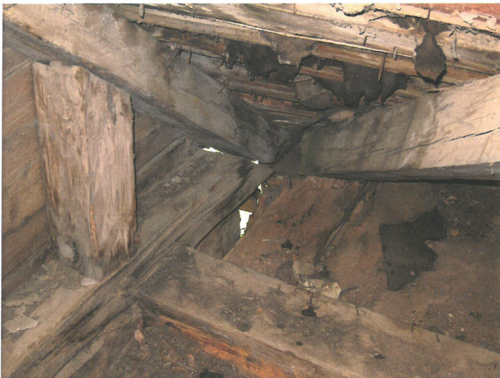
Foto 10: Vaade kahjustunud neelule pööningul
