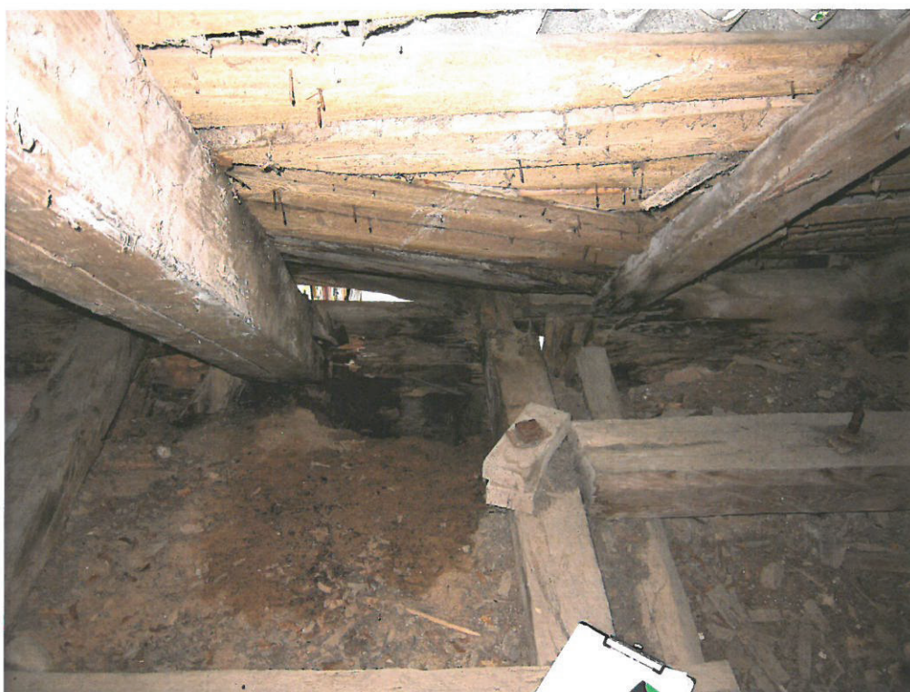
Foto 11: Vaade kahjustunud neelule pööningul
