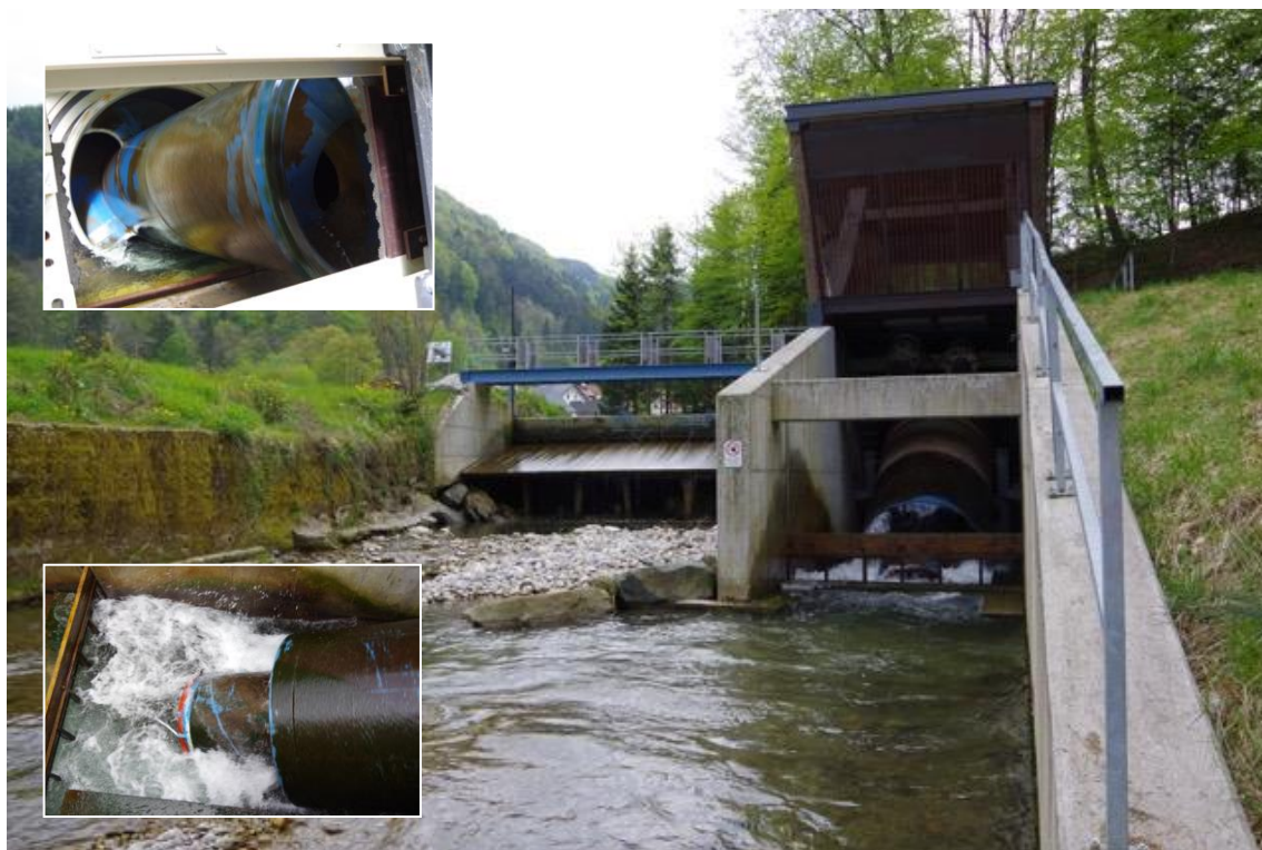
Foto 3. Topeltkruvi – turbiin ja kalatõstuk ühes seadmes Jessnitzis jõujaamas Neubruckis Austrias. Vaade vastuvoolu. Lisapiltidel kruvitoru veehaare (ülemisel) ja väljavool/kalapääsu sissepääs (alumisel).
