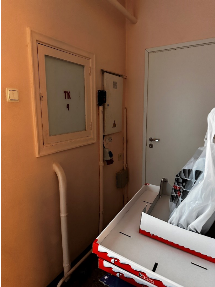
Olemasolev külakeskuse elektrikilp. Olemasoleva kilbi asemele projekteeritakse uus kilp.
