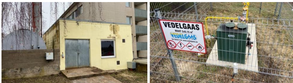
Joonis 3.52. Tilsa katlamaja põlevkiviõli mahuti, hoone ja LPG aurusti.
