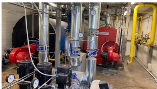
Joonis 3.18. Ringluspumpad ja katlad
